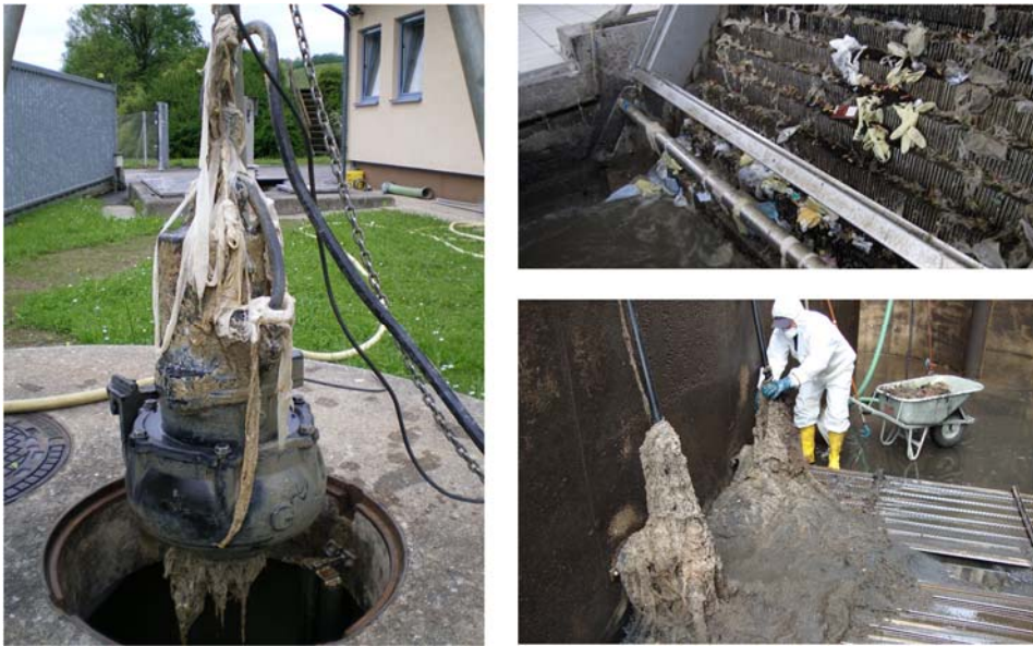
Abbildung 1: Problematik von FT in einer Rechenanlage (rechts oben), bei der Verstopfung von Pumpen (links) und anderen Einrichtungen von Kläranlagen (rechts unten).
