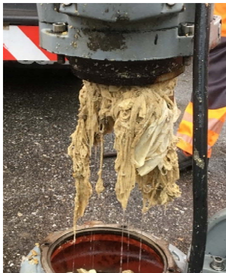
Abbildung 6: Eine zerlegte Pumpe mit Verzapfung aus FT aus einer Pumpstation in Kapfenberg
